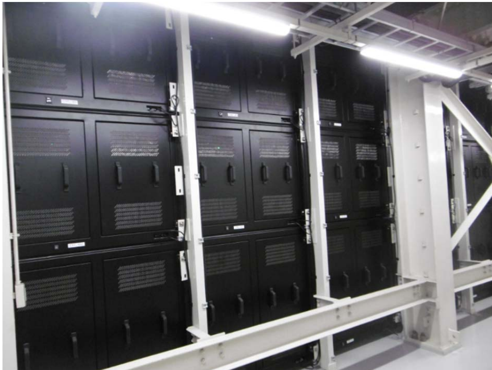
電光表示盤の内側
