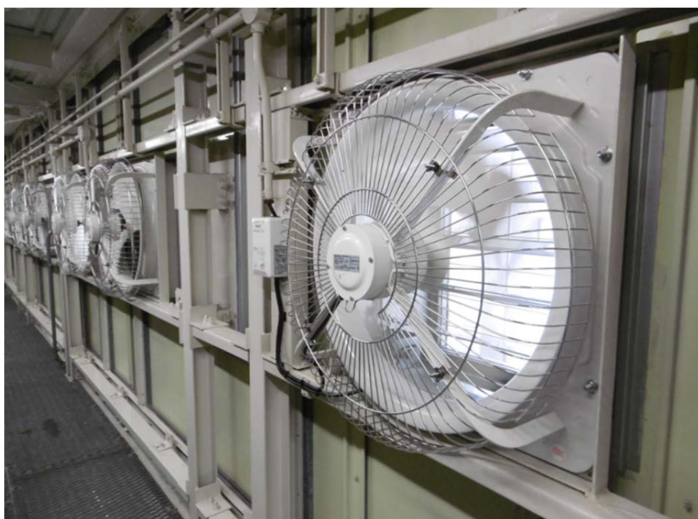
設備内の温度上昇を抑える換気装置（換気風量：7, 020 m 3 /h × 8 台）
