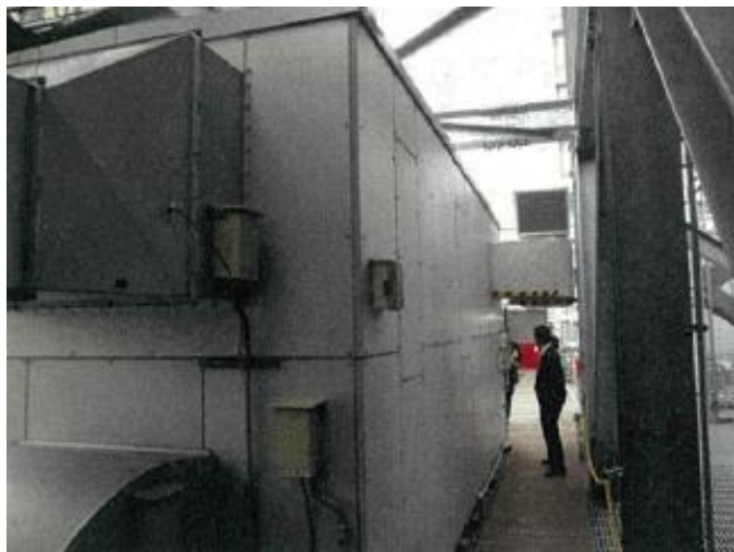
デシカント空調設備(ヤンマー本社ビル)
